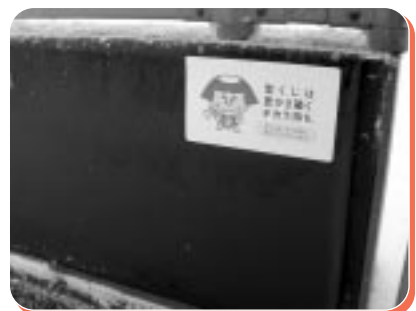
ラバーフェンスで安全となった野球場フェンス
